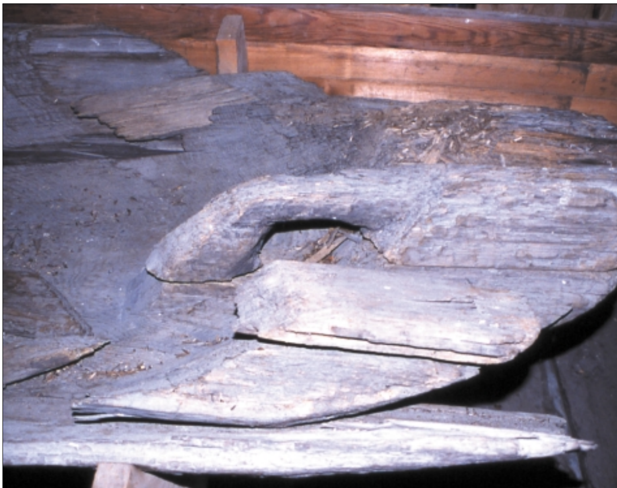
Fig 3: Detalj av utsparring til "Håndtak". (Foto: Pål Nymoen)
